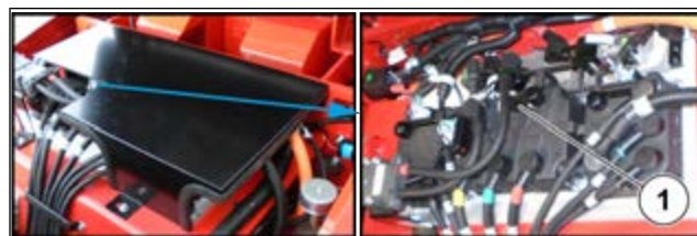
Afbeelding 85: De stroomzekeringen controleren
