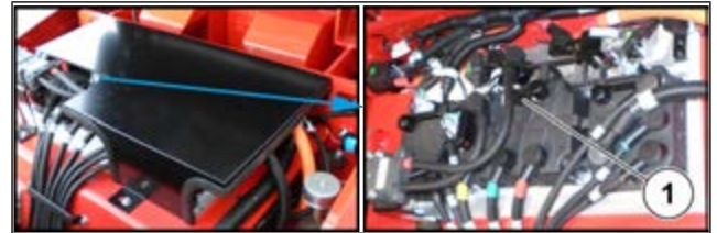
Figure 85: Vérification des fusibles d'alimentation
